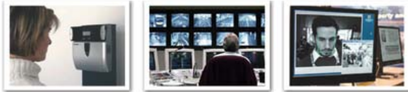
Figura 3: Biometría de iris para la sala cofre. Figura 4.1 y 4.2: Biometría de rostro para la sala cofre.
